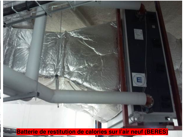
Batterie de restitution de calories sur l'air neuf (BERES)
