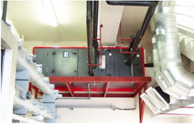
Système de traitement d'air ECO MODUG du local UF
