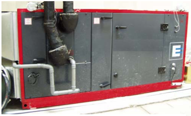
Système de traitement d'air ECO MODUG du local Filtration
