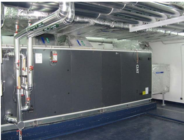
Centrale de traitement d'air
