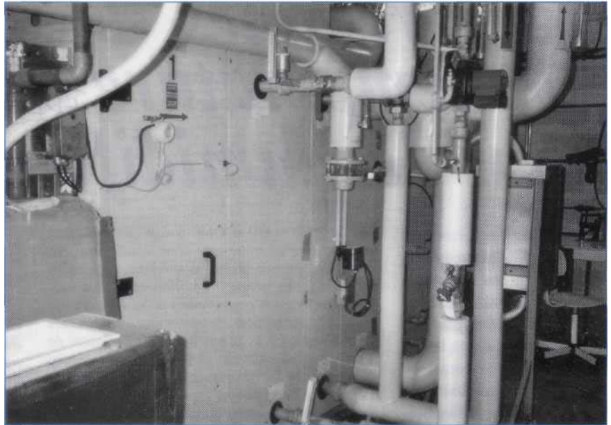
La centrale de traitement d'air existante. Au premier plan, l'alimentation des batteries.
