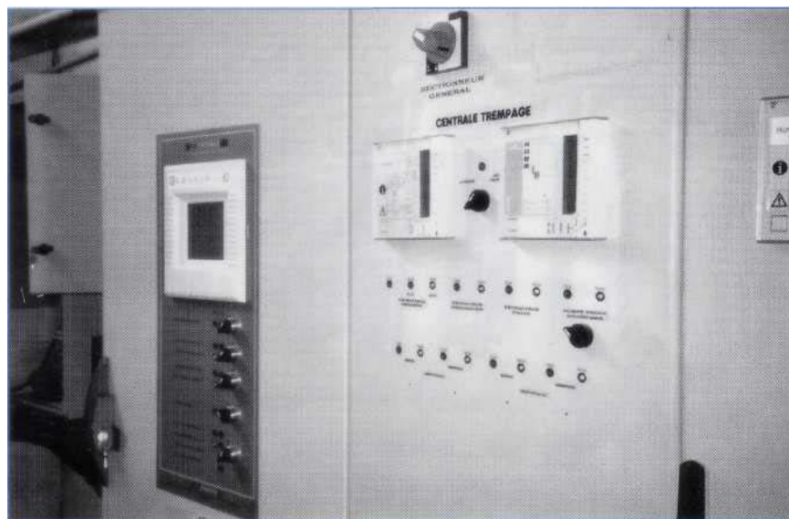
Le système de régulation des centrales de déshumidification et de traitement d'air.
